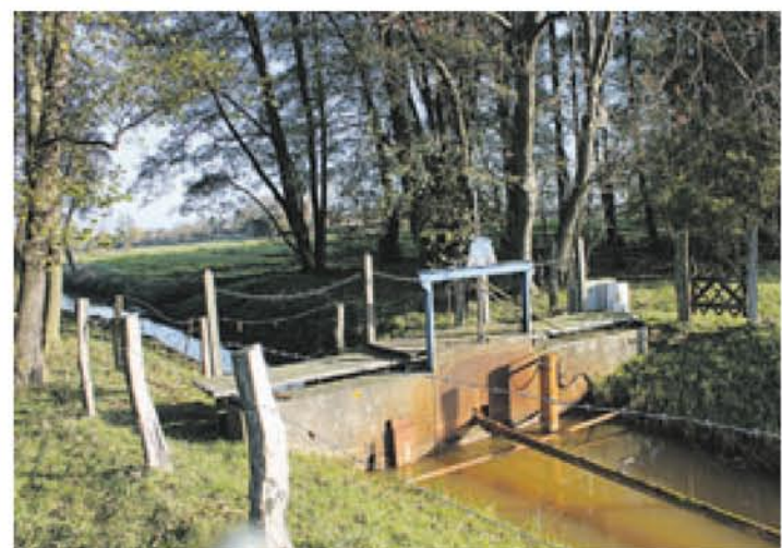
Die Pumpe Jacobsberg muss modernisiert werden. Sie liegt an den Rethwettern. Fotos: ten
